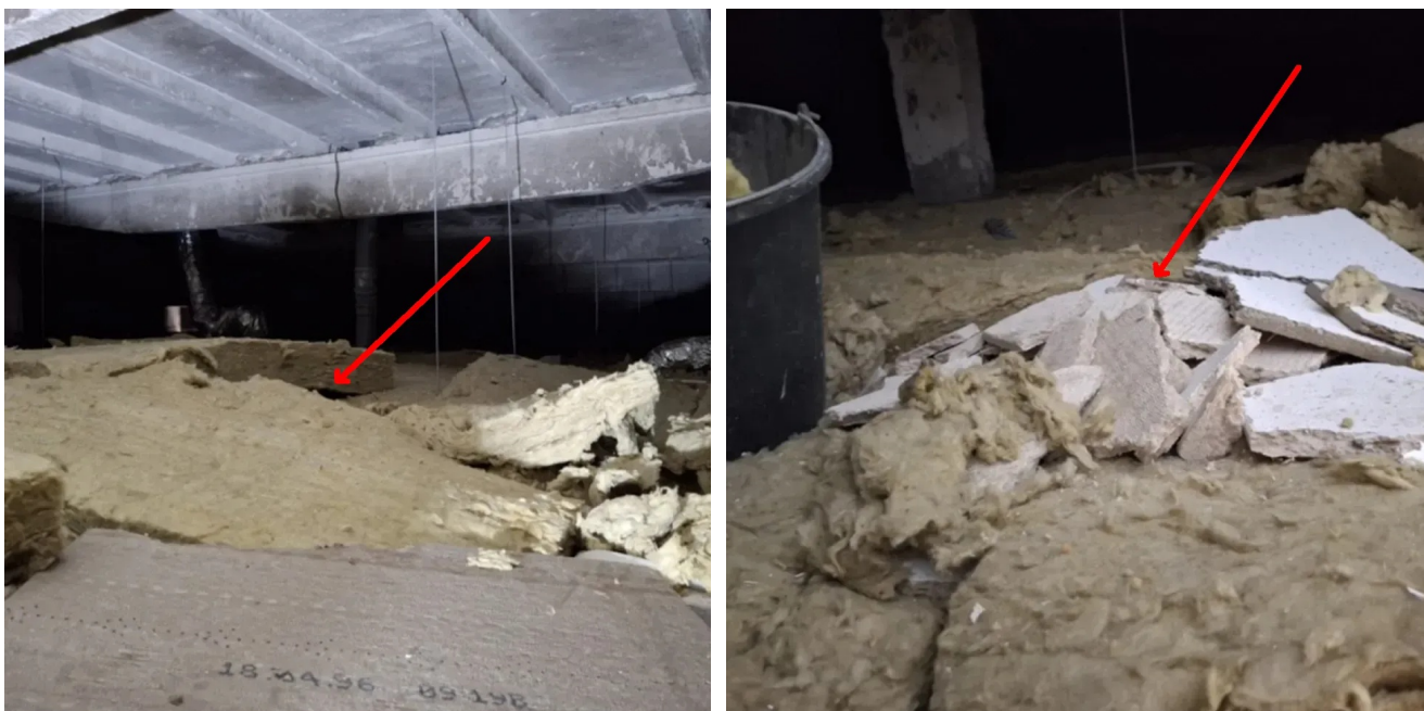
Zdjęcia nr 4 i 5 Stwierdzono brak ciągłości izolacji oraz gruz budowlany
