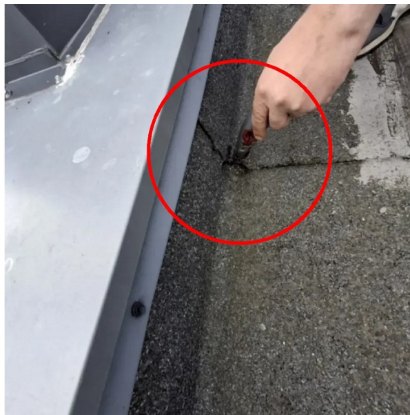
Zdjęcie nr 3 Widok dachu - brak fasety przy ściankach attykowych
